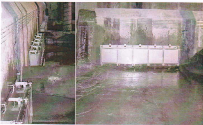
安装于调蓄池内的冲洗门系统
