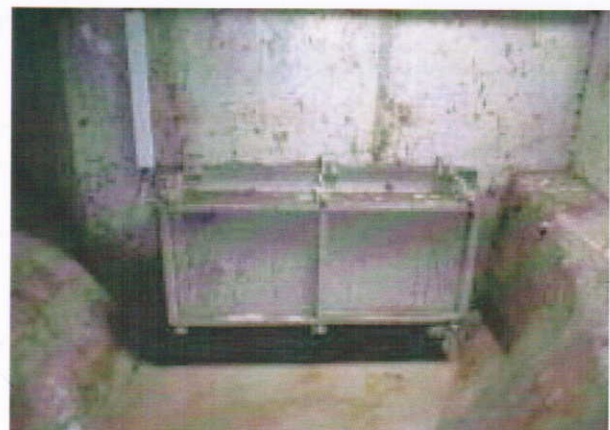
安装于箱涵中冲洗门
